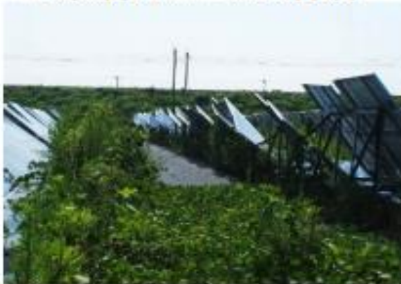
放置されたパネルの現況
